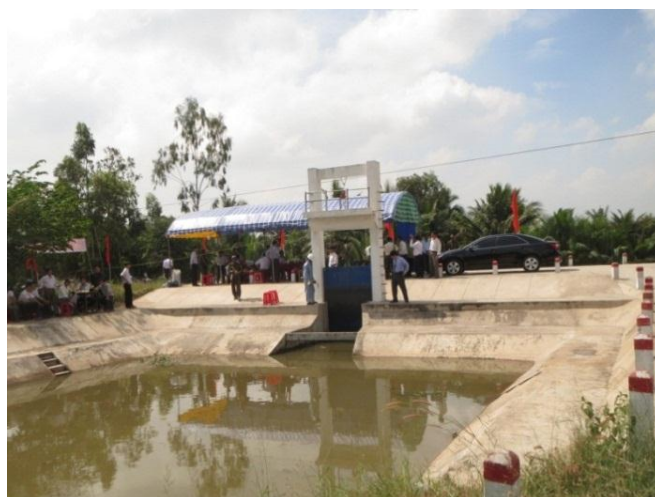
Cống Thủy lợi khi được mở lên
