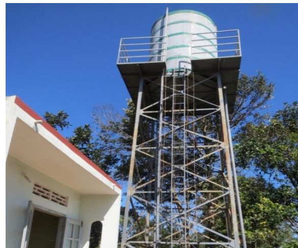
Đài nước được trang bị từ dự án
